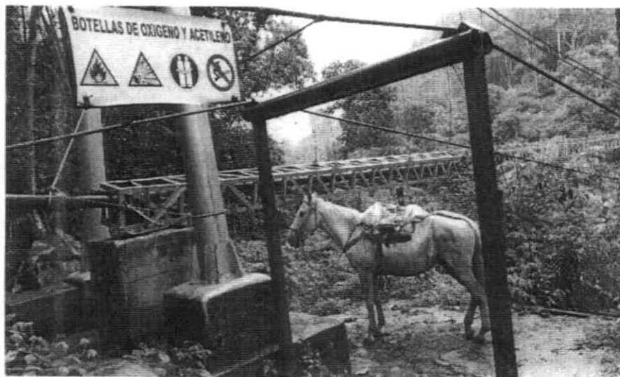
Foto 1. Se evidencia desplazamiento desnivel del puente que contiene el ducto del gas y los tornillos sueltos.
