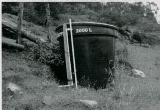
TANQUE PARA AGUA POTABLE
