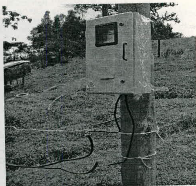
CONEXIONES ELECTRICAS DEFECTUOSAS
