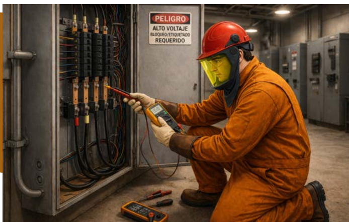
Figura 21. Verificación de ausencia de tensión Fuente: imagen generada con ChatGPT - Open AI (2026).
