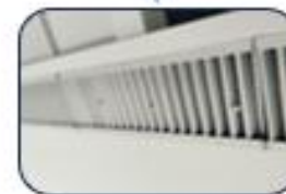
*Rejilla de ventilación
