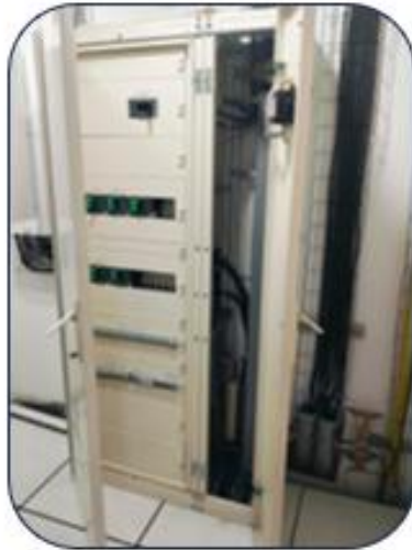
*Puntos de cableado estructurado
