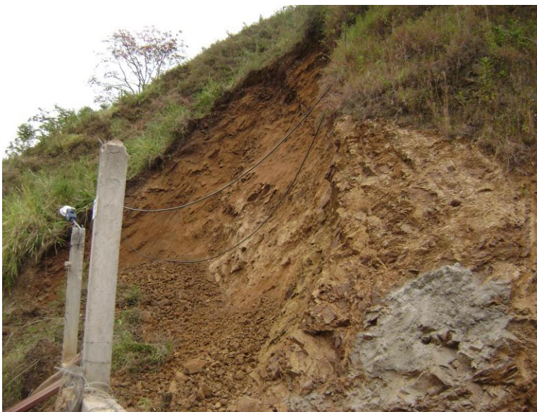
DESPRENDIMIENTO DE MATERIAL EN LA PARTE ALTA DEL TALUD
