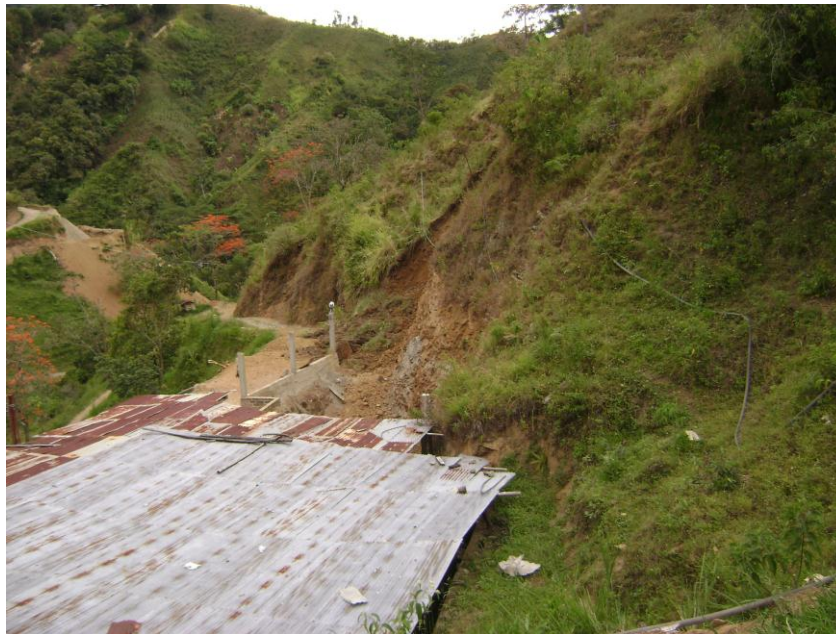
ESCAVACION EN LA PATA DEL TALUD
